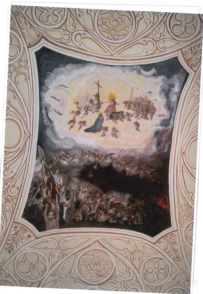
Fot. 7. Polichromia wewnątrz kaplicy – sufit, 2019.
